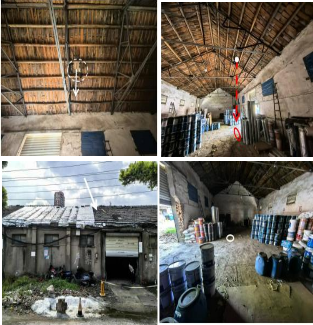
图2 事故（救援、洞口暂时修复后，8月28日下午）现场照片
